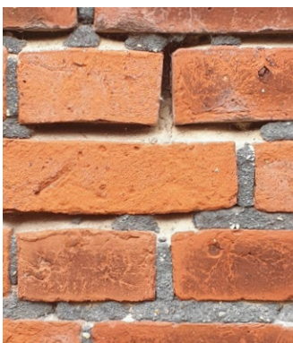
Eksempel på murværk omfugget med cementmørtel, hvor fuge og mursten ikke kan arbejde sammen. Bagved cementfugen ligger den gamle kalkfuge.
